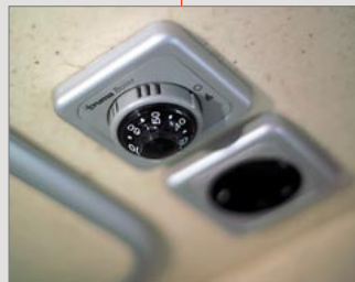
Bedieneinheit Boiler (Decke)
