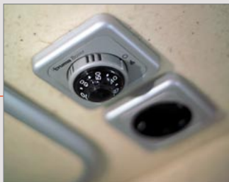
Boiler einschalten (Decke)
